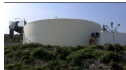
tipo 6N.3 depuratore di Sarsina - scheda - n.329
