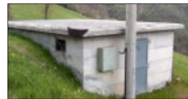
tipo 6N.1a - cabina Enel - scheda n. 300
